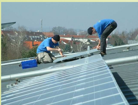
Foto: Verein für Klimaschutz und Solarförderung am Gymnasium Neutraubling e.V
