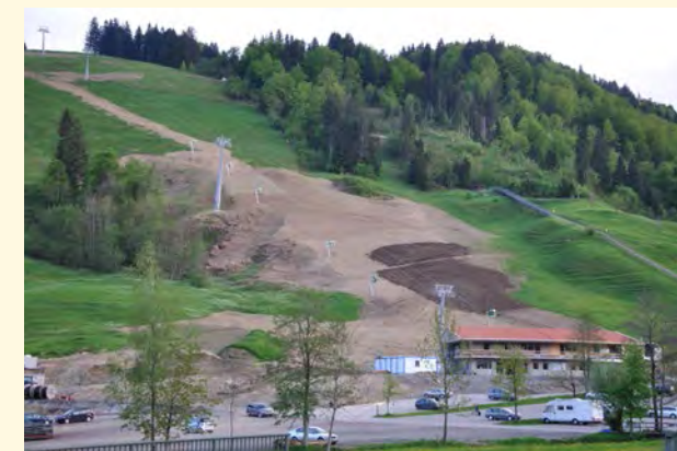
Auch in vielen Skigebieten in niedrigen Lagen, wie hier am Hündle bei Oberstaufen, versucht man, mit Beschneiungsanlagen und Pistenplanierungen noch Wintersport zu ermöglichen.
