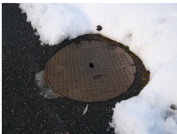
Abb. 12: Im Teilstück Hinterburg wurden von dem Strassenunterhaltungsdienst der Gemeinde Bäretswil verschiedene Gullys mit ritzenlosen Deckeln verschlossen. Die Schächte hatten sich als Amphibienfallen erwiesen und waren zur Entwässerung nicht dringend benötigt worden.
