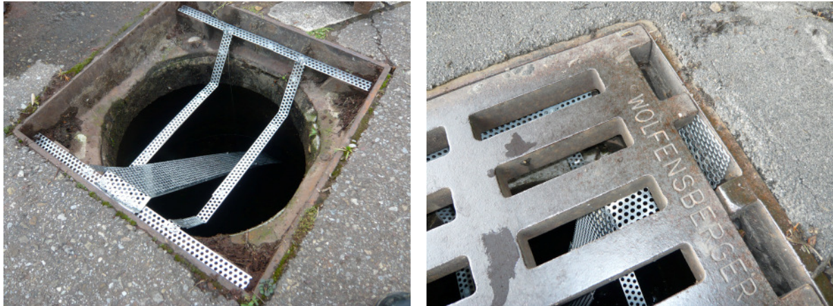
Abb. 8: Eine Ausstiegsleiter verbindet die Wasser führende Zone und Schlitze der Schachtabdeckung.
