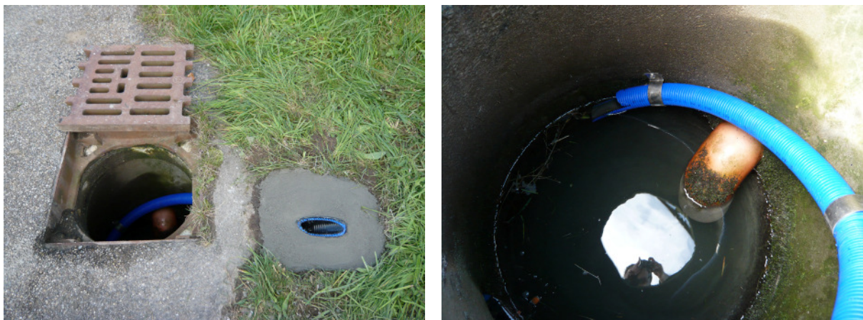
Abb. 7: Ein entlang der Schachtwand führendes und diese im oberen Bereich durchdringendes Ausstiegsrohr führt direkt in den Grünbereich. Diese Ausstiegshilfe ist seit September 2007 im Teilgebiet Wappenswil im Einsatz.
