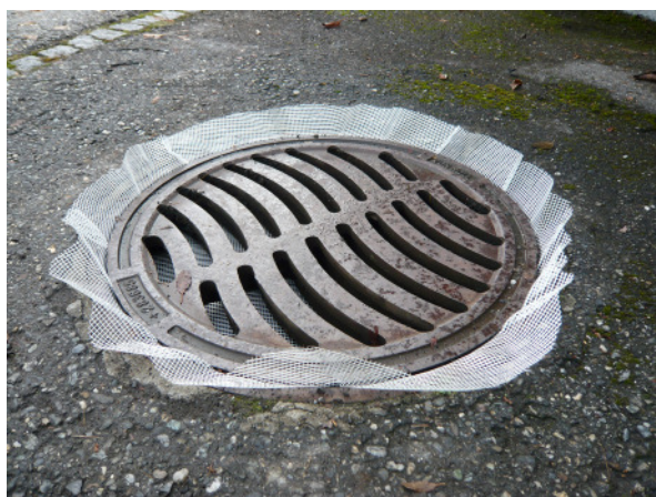
Abb. 11: Fixe Vergitterung – nur eine Möglichkeit für Schächte, die ständig beaufsichtigt werden und für Schächte, bei denen kaum Schwemmgut anfällt.
