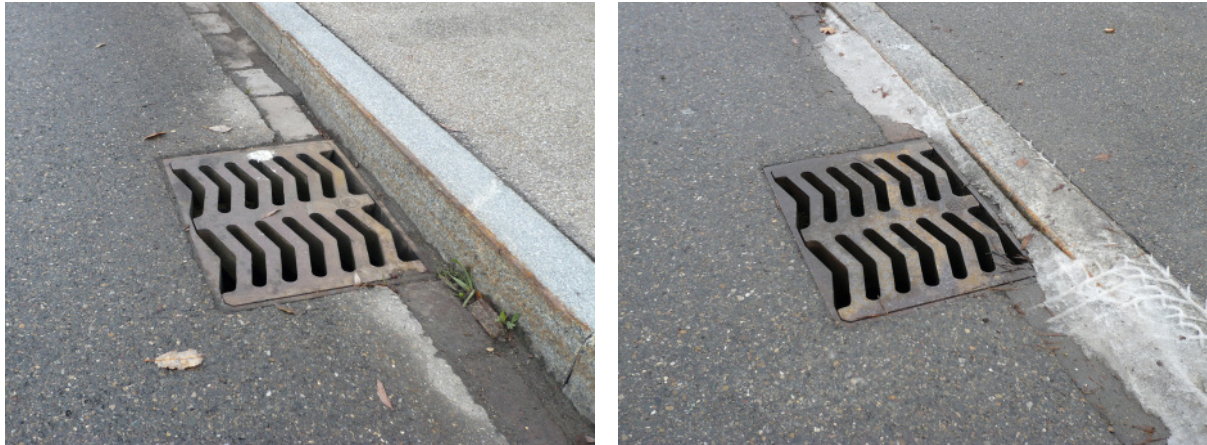
Abb. 13: Randsteine werden von Amphibien oft nicht überwunden und lenken die Tiere direkt zum Schacht. Das Abschrägen ist eine wirkungsvolle Massnahme, um das Fallenproblem zu entschärfen.
