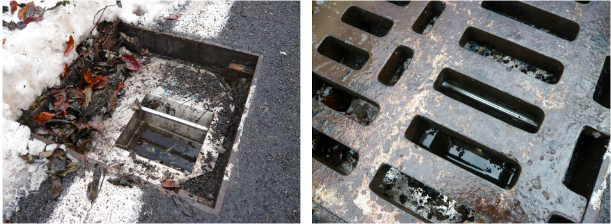
Abb. 9: Der dicht unter dem Gussdeckel eingesetzte Siphon hindert Amphibien in die Tiefe des Gullys zu gelangen.
